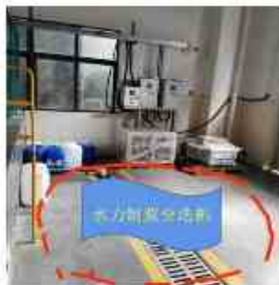
水力制浆分选机：位于除臭风机房内
